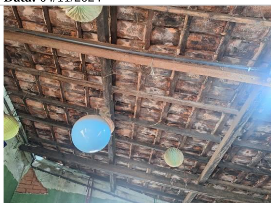
Figura 10: Cobertura do bar, com danos. Autoria: Ana Luiza Cecílio Data: 04/11/2024
